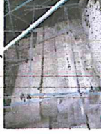
EMMR. 2017. TEMPLO IV. LADO NORTE, EXTREMO ESTE, SEGUNDO BASAMENTO, MURO NÚMERO 1. PROCESO DE CONSERVACION ARQUITECTÓNICA.
